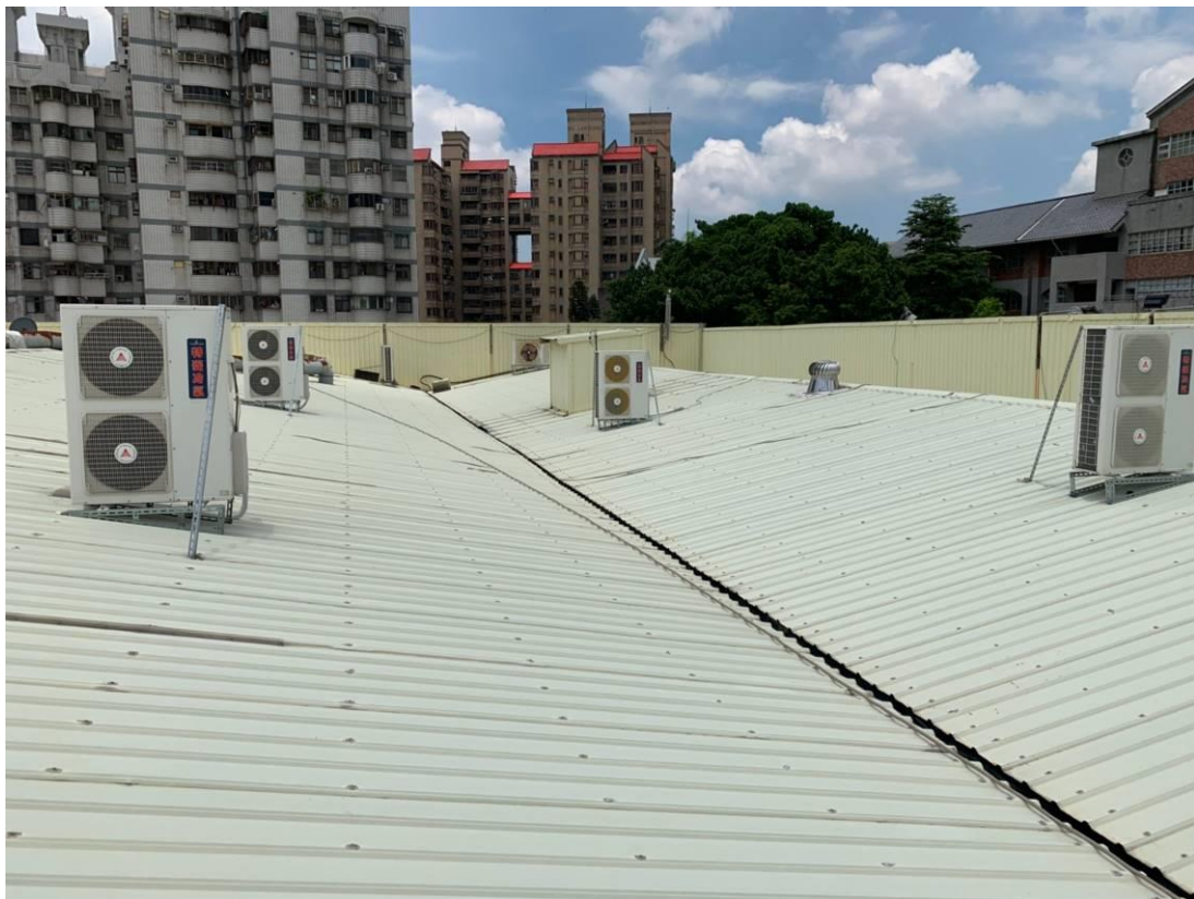
圖 6.3-10 屋外空調及冷凍冷藏主機應加遮陽篷防日曬提高效率
