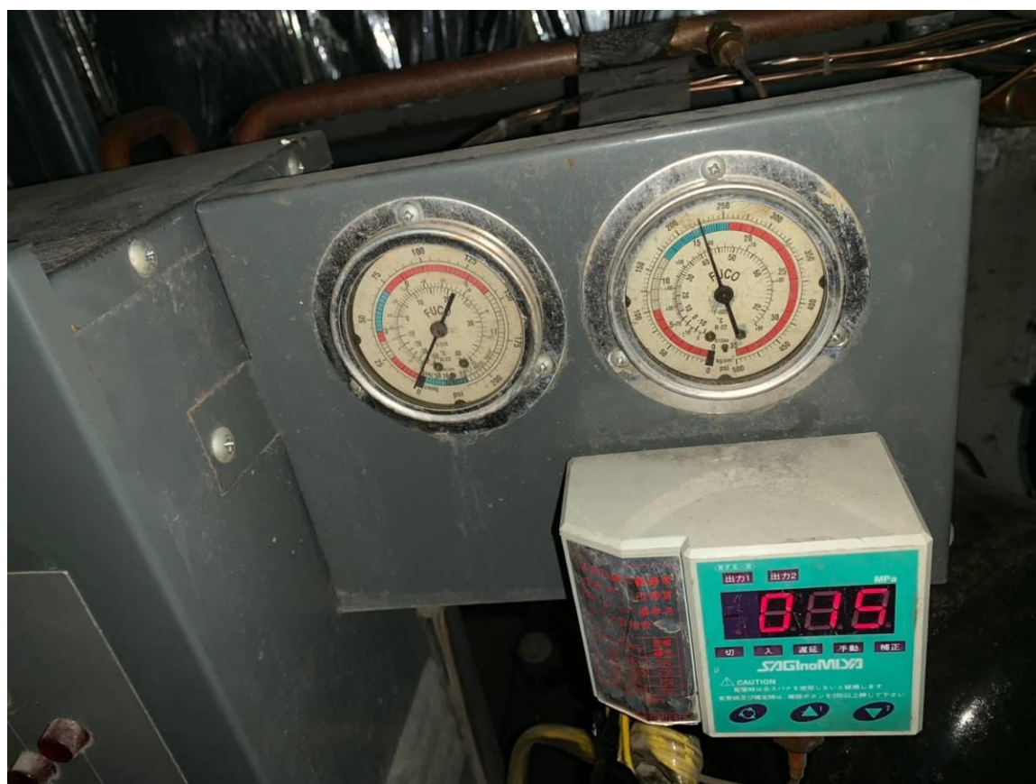
圖 6.3-8 冷凍冷藏主機定期高低壓抄錶檢討調整減少耗電
